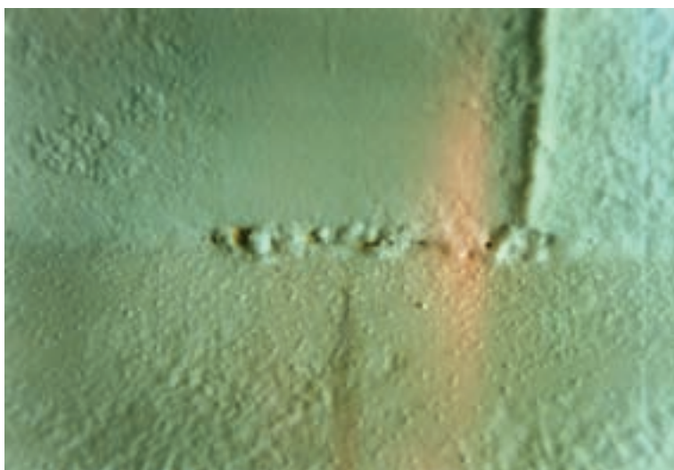
شکل ۶-۳ - جوش کاری و آماده سازی نامناسب
