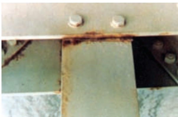
شکل ۶-۴ - آسیب دیدگی در قسمت درزهای محل اتصال
