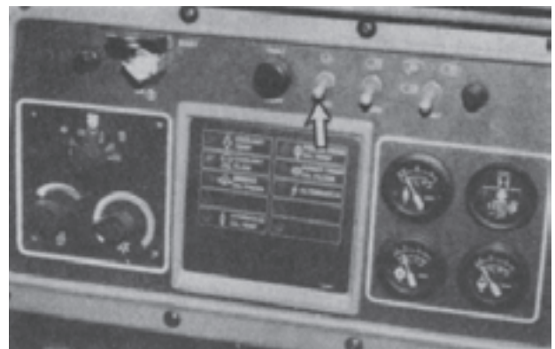
شکل ۳-۵- کلید آزمایش سیستم هشداردهنده
