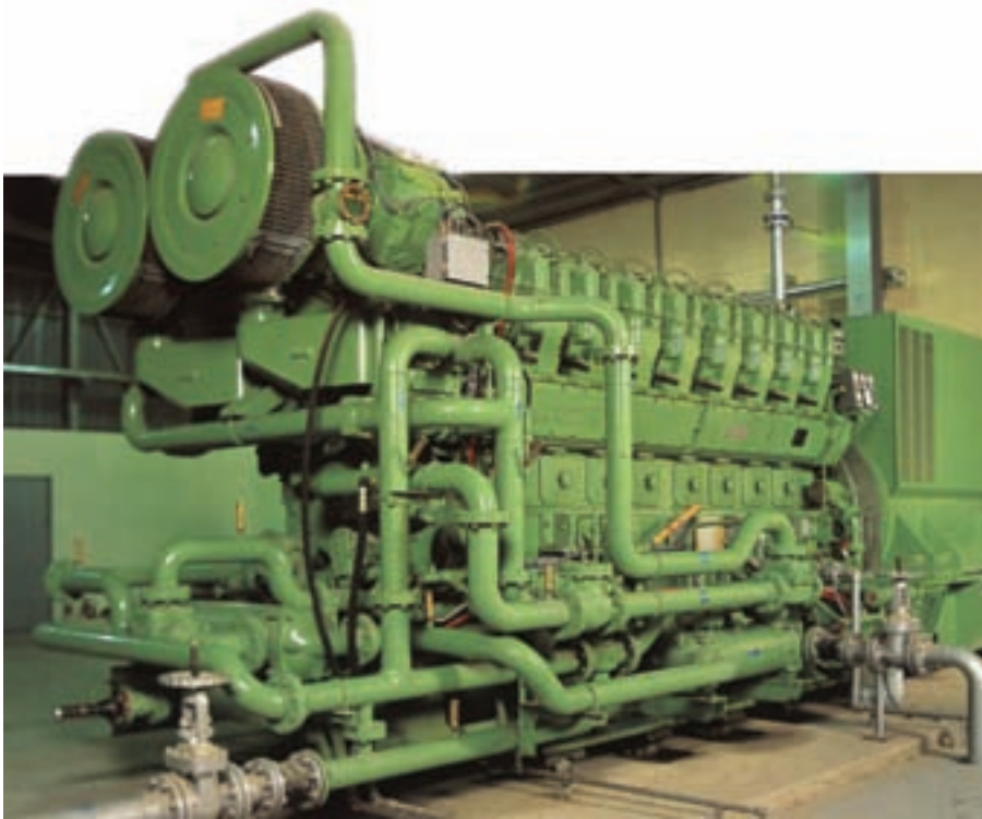
شکل ۲-۸- موتور ژنراتور یک نیروگاه برق اضطراری معدن
