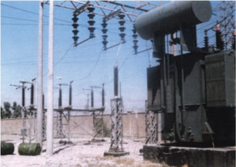
شکل ۵-۸ - قسمتی از یک پست اصلی برق
