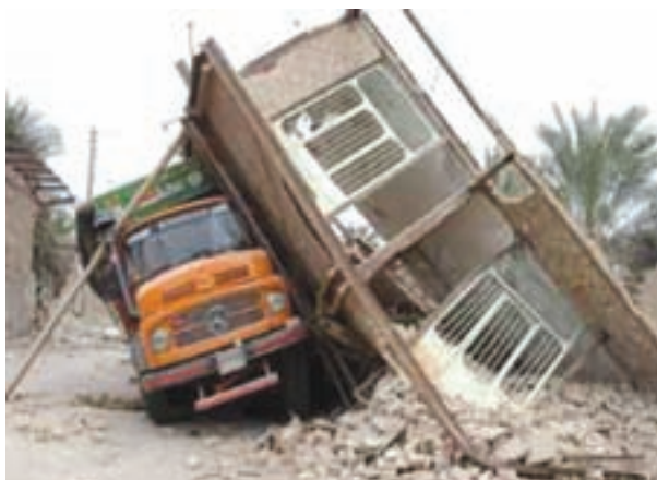
د) ریزش دیوار در اثر زلزله
