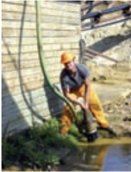
شکل ۲-۳۲- کاربرد پمپ کفکش
