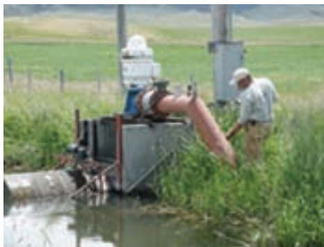
شکل ۱-۱- پمپ در حال انتقال آب از کانال
