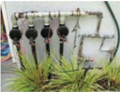
ب) شیرهای کنترل برقی در مسیر لوله‌های آبیاری
