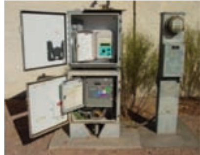
الف) تجهیزات کنترل برق مرکزی سیستم آبیاری
