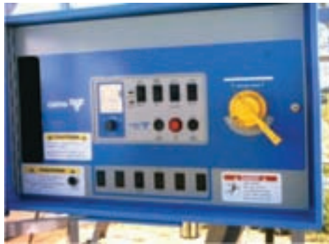
شکل ۷۱-۷- تابلو کنترل دستگاه سنتریوت
