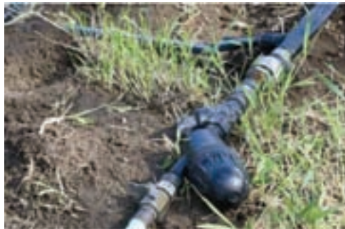
الف) فیلتر در مسیر شبکه آبیاری
