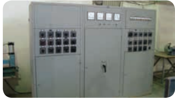
شکل ۵-۹۷ تابلو اصلی سه فاز برق کارگاه
