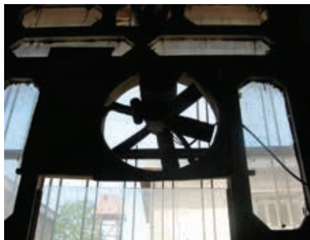
شکل ۳۸-۸- هواکش بزرگ در کارگاه.
