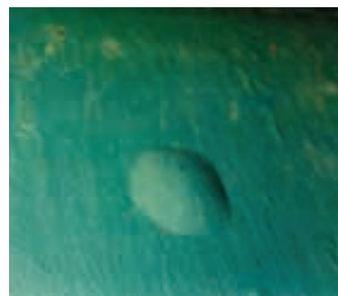
شکل ۸-۴۴- تاول زدگی سطح کار بعد از رنگ.
