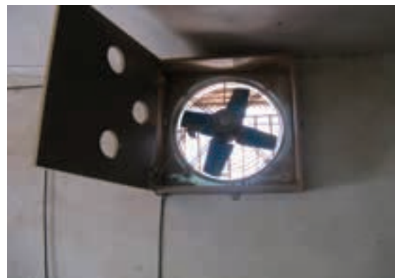
شکل ۴۷-۱۳- یک دستگاه تهویه در اتاق رنگ‌کاری.
