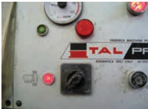
شکل ۲۳-۱۵- کلید روشن کردن پمپ (الکتروپمپ های ۱ و ۲).
