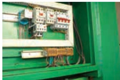
شکل ۱۵-۳۸- فیوزهای فودکار مینیاتوری روی تابلو برق پرس.
