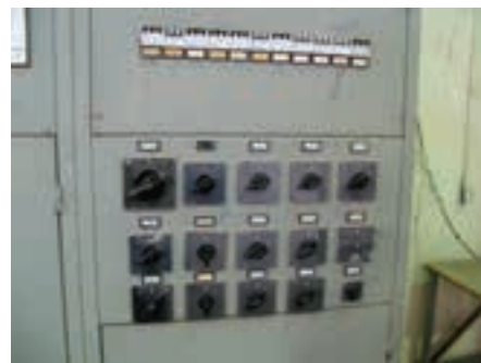
شکل ۱۵-۳۶- کلید اصلی پرس (دیف بالا سمت چپ در تابلوی ورودی برق).
