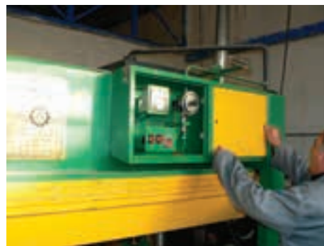
شکل ۱۵-۳۷- تابلوی نصب شده روی دستگاه پرس.
