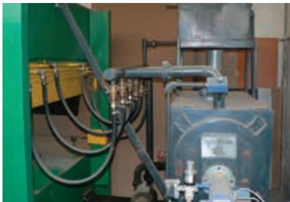
شکل ۱۷۶-۱۵- کنترل اتصال شیلنگ‌های روغن به صفحات پرس.
