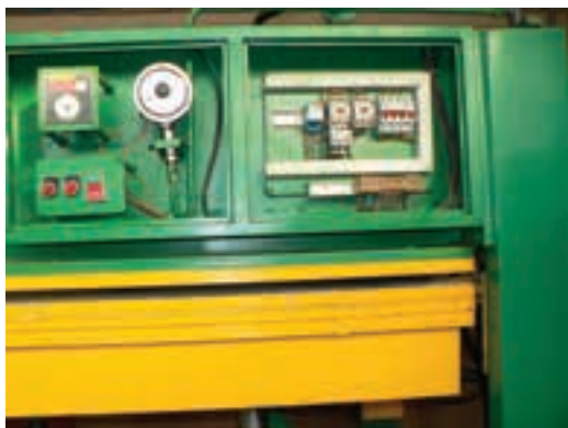
شکل ۱۵۴-۱۵- نمونه اتصال برق به کلیدی مینیاتوری در تابلوی برق پرس.
