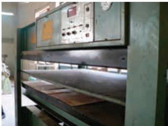
شکل ۱۵۰-۱۵- تابلوی اختصاصی برق نصب شده روی پرس برق.
