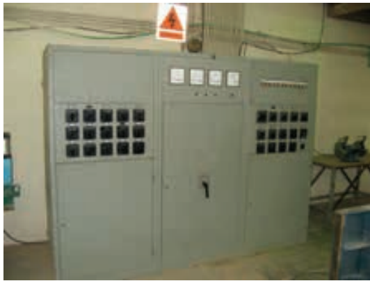
شکل ۱۴۹-۱۵- تابلوی اصلی برق ماشین‌آلات کارگاه صنایع چوب.
