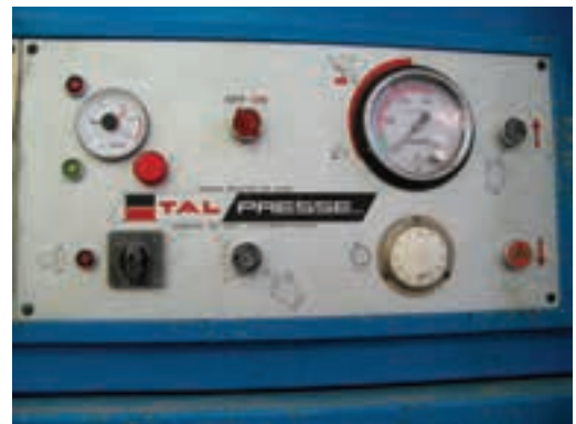
شکل ۱۶۲-۱۵- تابلو کنترل و کلید روشن کردن پرس.
