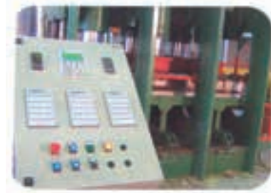
شکل ۱۱۲-۱۵- تابلو کنترل برقی سیستم پرس (روکش ملامینه).
