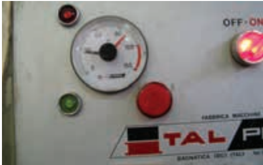
شکل ۱۳۱-۱۵. گیج تنظیم حرارت یک پرس برقی.
