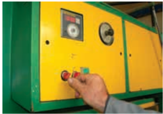
شکل ۱۵۱-۱۵- تابلوی برق اختصاصی (روی پرس روغنی).
