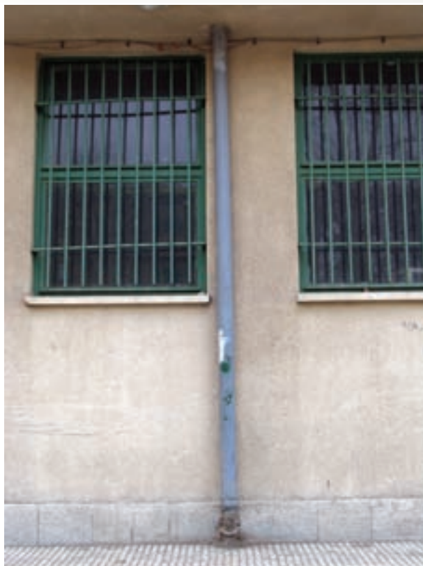
شکل ۱۰-۳ - لوله‌ی آب باران (ناودان)
