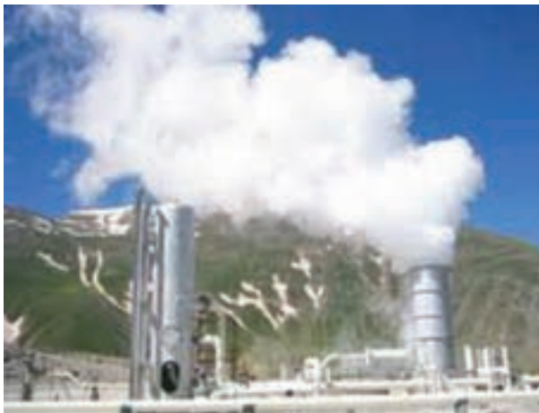
شکل ۱-۸- نیروگاه زمین گرمایی مشکین‌شهر - اردبیل
