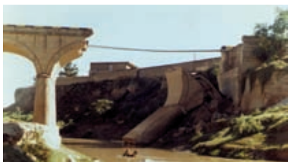
شکل ۱۵-۶- تخریب یک پل ارتباطی بر اثر سیل
