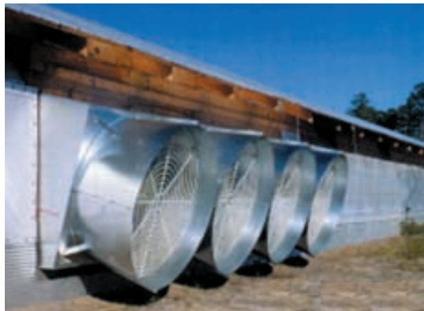
نمای هواکشها از بیرون جایگاه
