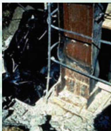
کمانش موضعی بال ها و جان ستون در پایین ستون طبقه ی اول در گوشه ی ساختمان
