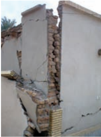
عدم اجرای شناژهای افقی و قائم موجب تخریب دیوار شده است.
