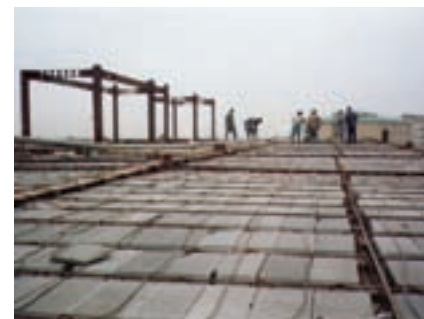
قرار دادن آرماتور حرارتی بر روی بلوک‌های سقف تیرچه بلوک برای جلوگیری از پدید آمدن ترک‌های عمیق در سطح بتن
