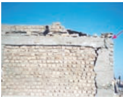
عدم اجرای صحیح شناژهای افقی و قائم و بتن‌ریزی ناصحیح شناژ موجب شده تا شناژهای قائم و افقی کاملاً از هم جدا شوند.
