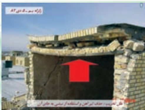
علل تخریب: حذف تیر آهن و استفاده از نبشی به جای آن
