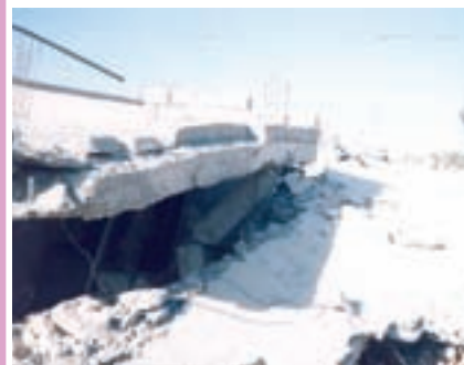
شکست ستون از محل درز اجرایی
