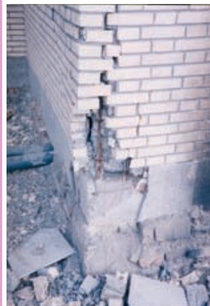
بتن‌ریزی نادرست شناژ قائم
