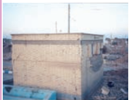
استفاده از آرماتورهای طولی ساده در شناژ افقی بالا بدون قلاب انتهایی و عدم رعایت فواصل خاموت‌ها موجب ایجاد خرابی در سازه‌ی یک طبقه کوچک شده است. در حالی که از چنین سازه‌ی سبکی انتظار می‌رود که در اثر زلزله آسیبی نبیند.
