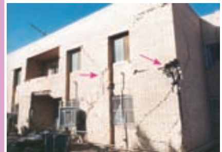
ایجاد ترک‌های قطری در اثر ضعیف بودن شناژ قائم
