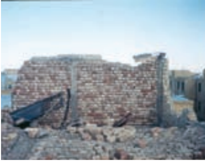
عدم رعایت طول مهاري مناسب در شناژ قائم و اجرا نکردن کلاف افقي زیر سقف
