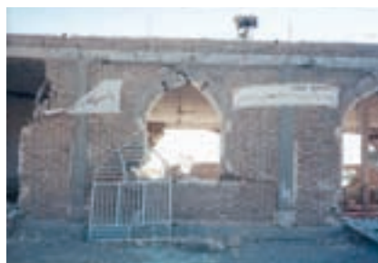
فاصله‌ی زیاد شناژهای قائم و فقدان پیوستگی دیوار به شناژ قائم موجب تخریب دیوار شده است.
