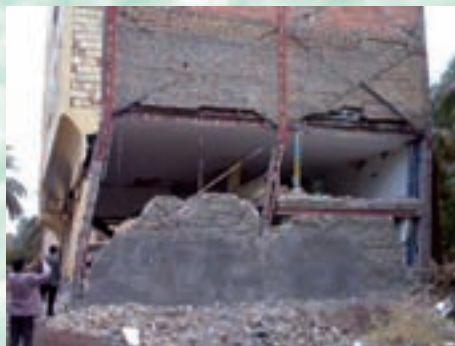
استفاده از مهاربندی ضعیف در یک جهت سازه که منجر به تغییر شکل زیاد سازه شده است
