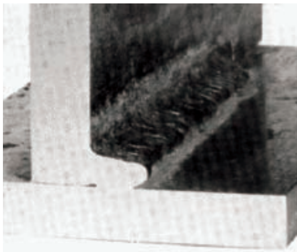
شکل ۱۲-۱۵- سرفتنگی در یک جوش گوشه
