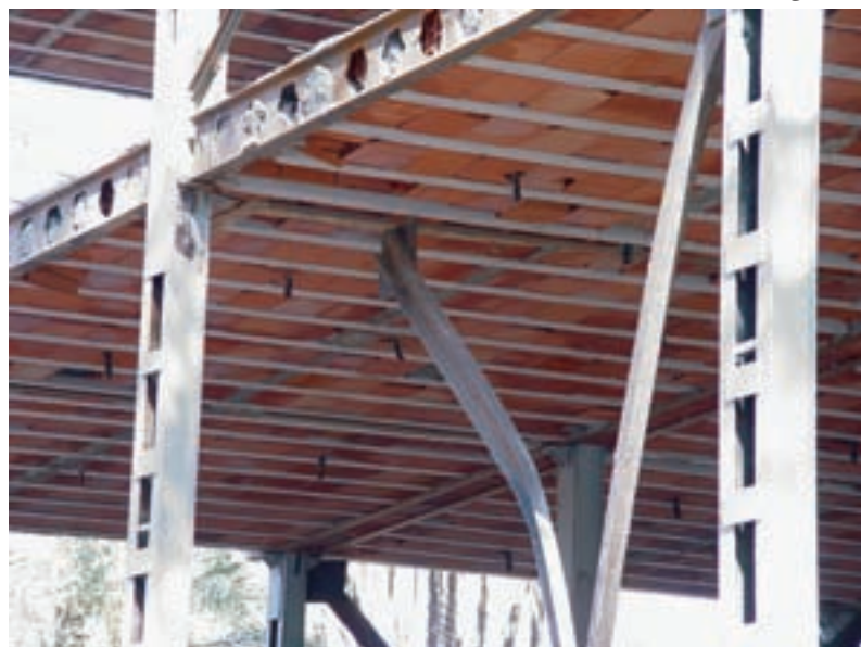
شکل ۱-۱۲- گسیختگی جوش در زلزله بم
