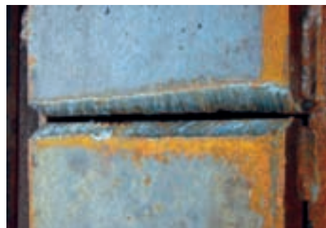
آماده‌سازی نامناسب درز جوش شیار
