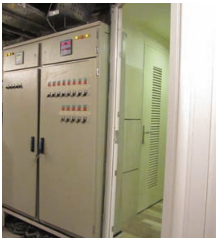
ب) تابلو برق سه فاز
