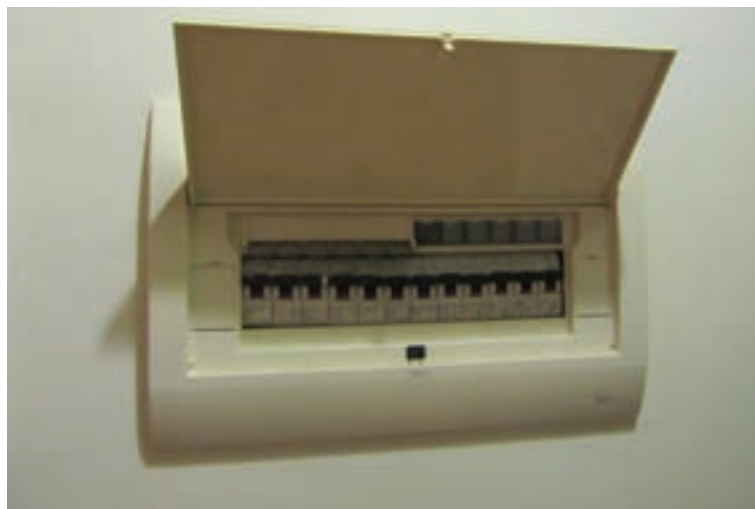
الف) تابلو برق تک فاز
