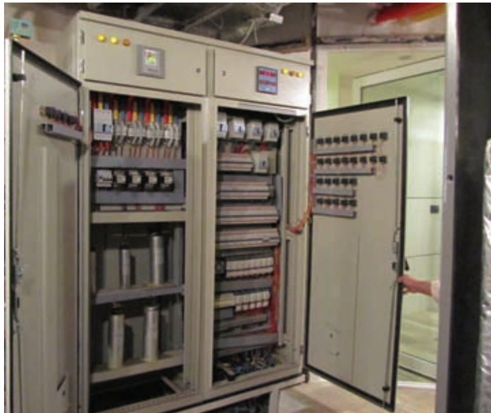
ب) باز شده تابلو برق
