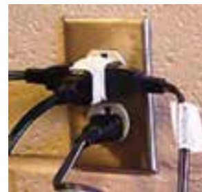
شکل ۲-۱۷ انشعاب غیر استاندارد از پریز برق.
