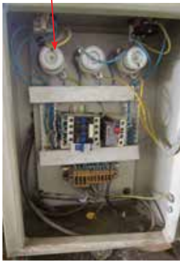
(ب) تابلو برق اره لنگ
