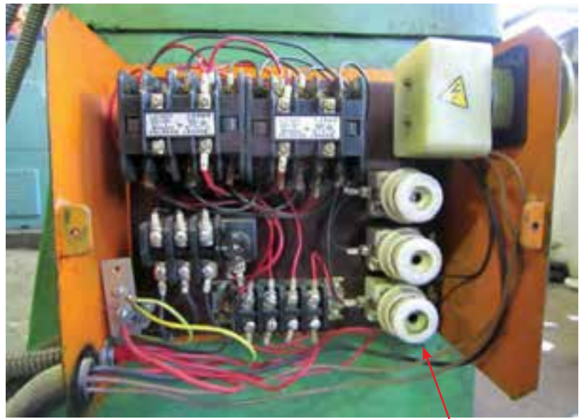
(الف) تابلو برق ماشین تراش
