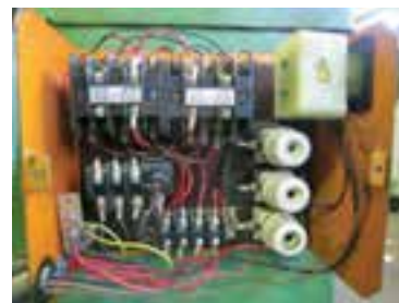
شکل ۵-۹۱ نمونه تابلوی برق دستگاه تراش
