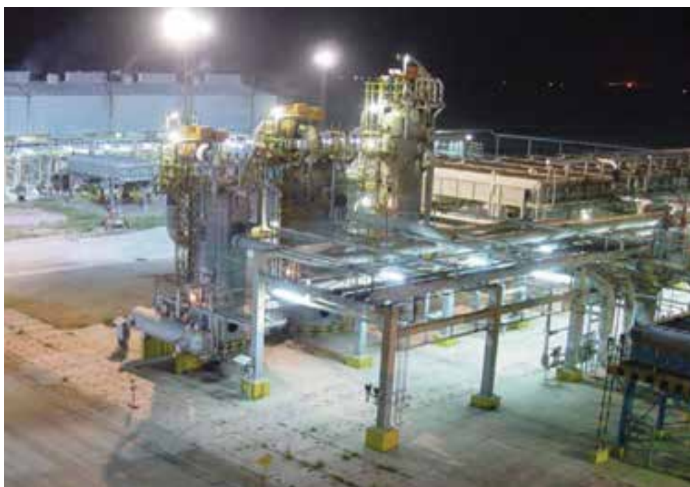
شکل ۳۱-۵ کارخانه گاز و گاز مایع شماره ۹۰۰- اهواز
