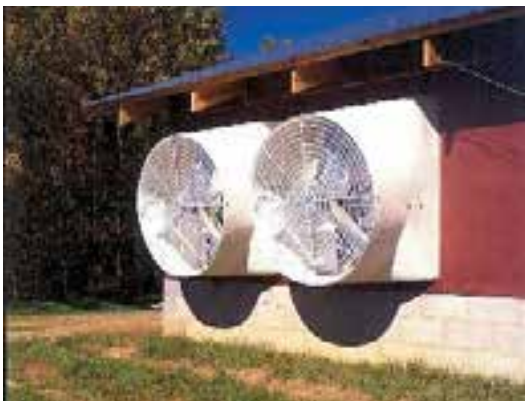
شکل ۱۸-۳- هواکش روی دیوارهای جانبی سالن پرورش طیور
