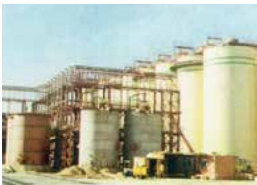
شکل ۱-۳۹- تأسیسات نفتی در جنوب
