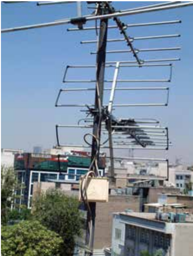
شکل ۱-۷۰- میکسر و محل نصب آن روی دکل آنتن
