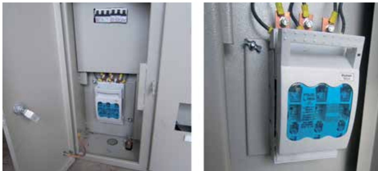
شکل ۲۳-۳- محل ورود کابل اصلی به داخل تابلو
