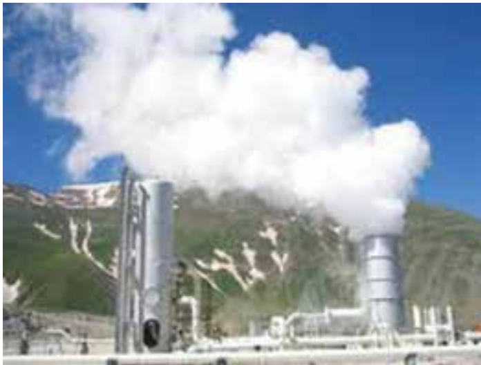
شکل ۱۲-۱۰- تصویر نیروگاه زمین گرمایی مشکین شهر
