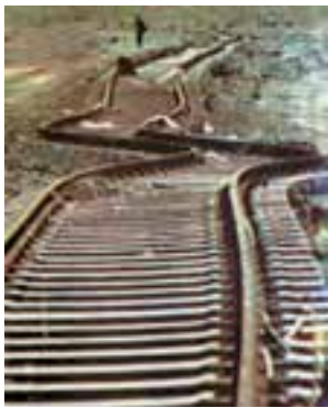
شکل ۶-۶- تخریب خط آهن بر اثر وقوع زلزله
