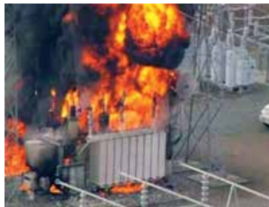
شکل ۲۰- انفجار ترانسفورماتور قدرت
