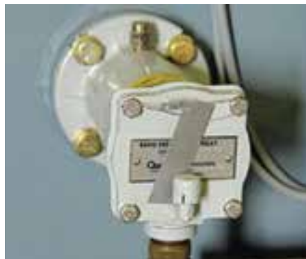
شکل ۳۳- رله فشار ناگهانی
