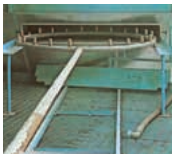
رینگ نازل‌ها در موقعیت خارج از برج خشک‌کن
