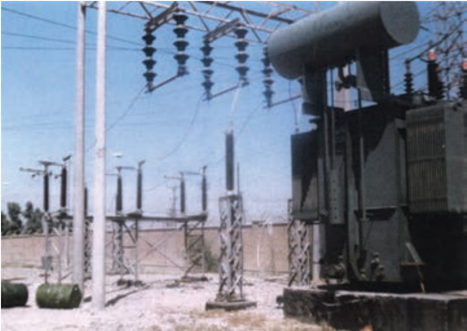
شکل ۵-۸ - قسمتی از یک پست اصلی برق
