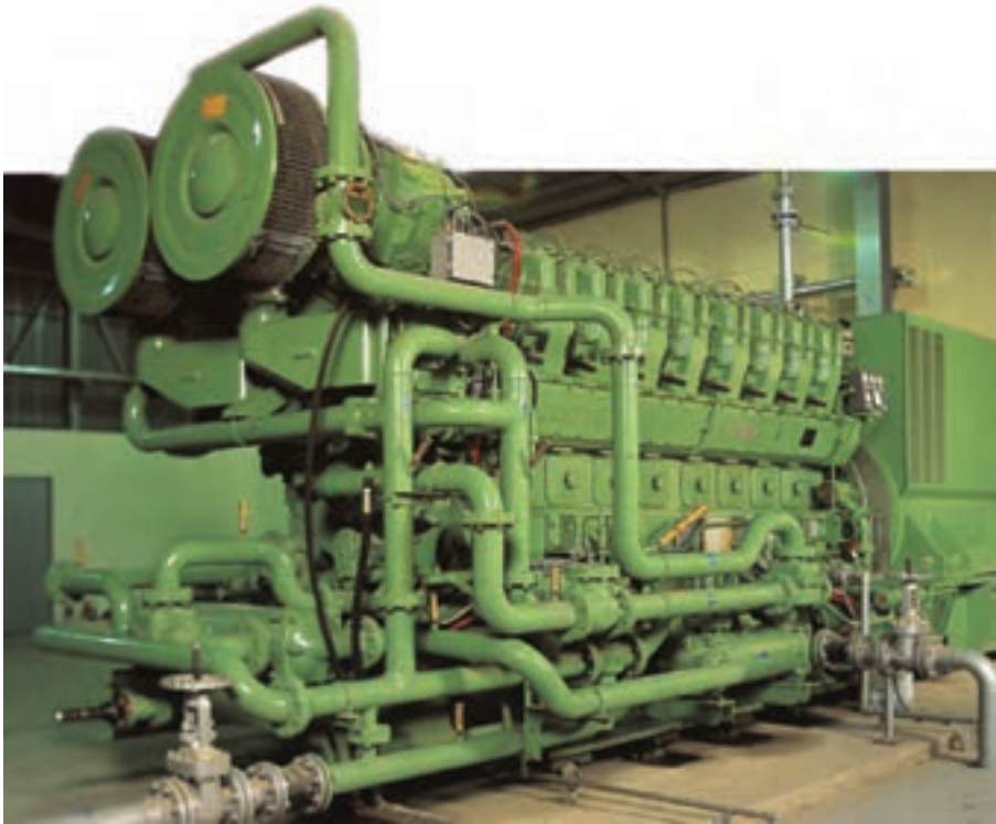
شکل ۲-۸- موتور ژنراتور یک نیروگاه برق اضطراری معدن
