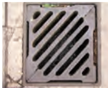
شکل ۱۰-۲ درب چاه های شهری از چدن
