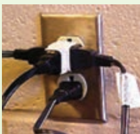
شکل ۲۳-۲- انشعاب غیر استاندارد از بریز برق
