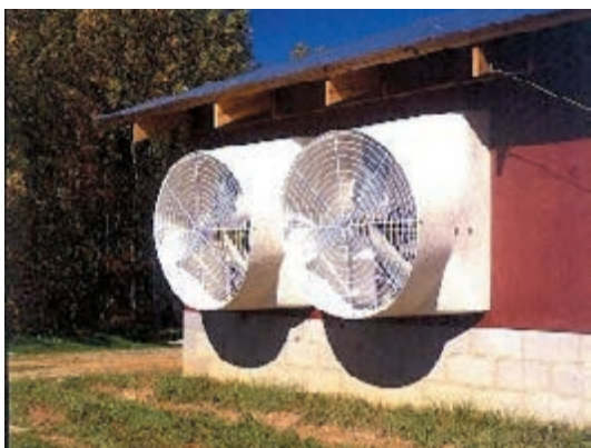
شکل ۱۸-۳- هواکش روی دیوارهای جانبی سالن پرورش طیور
