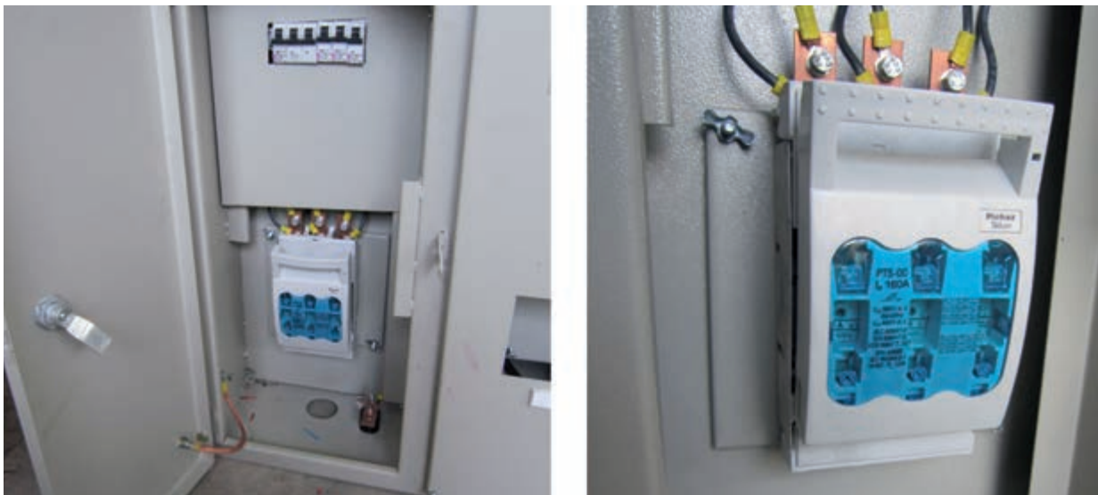
شکل ۲۳-۳- محل ورود کابل اصلی به داخل تابلو
