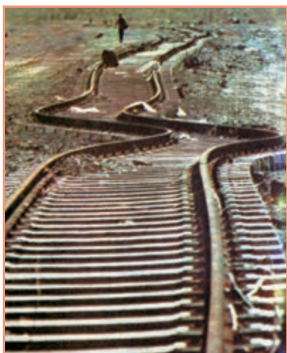
شکل ۶-۶- تخریب خط آهن بر اثر وقوع زلزله
