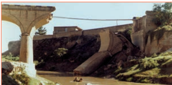
شکل ۱۷-۶- تخریب یک پل ارتباطی بر اثر سیل
