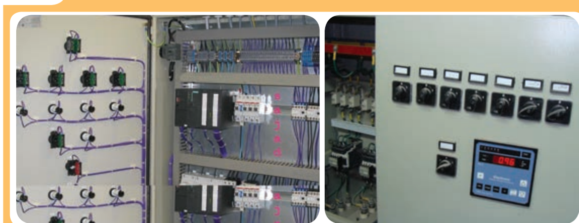
تابلوهای برق صنعتی موجود در کارگاه‌ها
