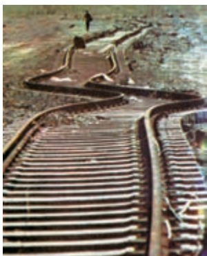
شکل ۶-۶- تخریب خط آهن بر اثر وقوع زلزله
