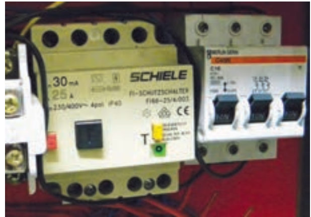
شکل ۲۱-۱- فیوز حفاظتی نصب شده در کارگاه
