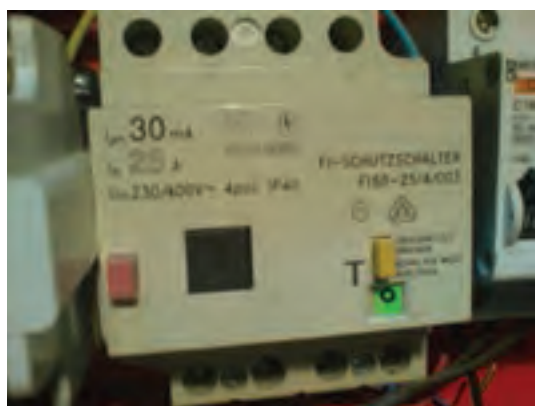
شکل ۱-۱۸ - فیوز حفاظتی نصب شده در کارگاه
