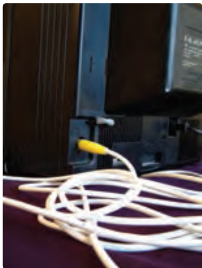
شکل ۴-۱۵- سیم کابل مناسب انتخاب نشده است.
