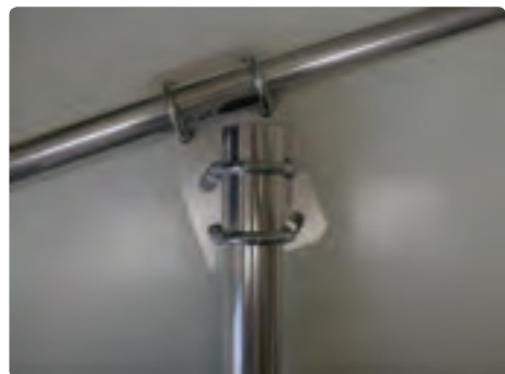
شکل ۴-۸ لوله نگه‌دارنده آنتن
