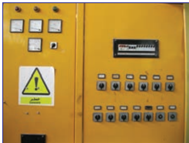
شکل ۱-۵- نمونه‌ای از تابلو برق
