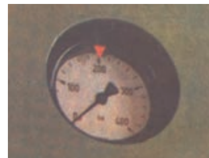
شکل ۲-۵۷ کنترل فشار روغن هیدرولیک
