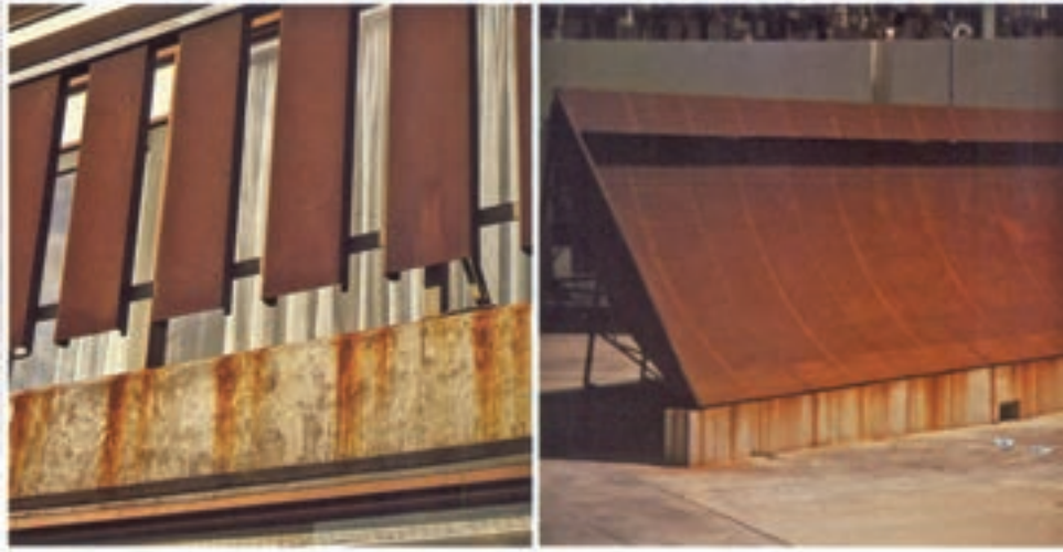
شکل ۷-۷. سطح زنگ‌زده ورق‌های آهنی در اثر قرار گرفتن در شرایط اتمسفر مرطوب
