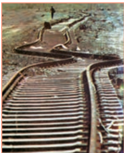
شکل ۶-۶- تخریب خط آهن بر اثر وقوع زلزله
