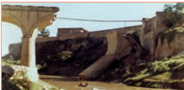
شکل ۱۷-۶- تخریب یک پل ارتباطی بر اثر سیل
