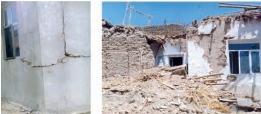
شکل ۳۶-۱- تصاویری از خسارت زلزله اردیبهشت ۱۳۸۱ در دینور
